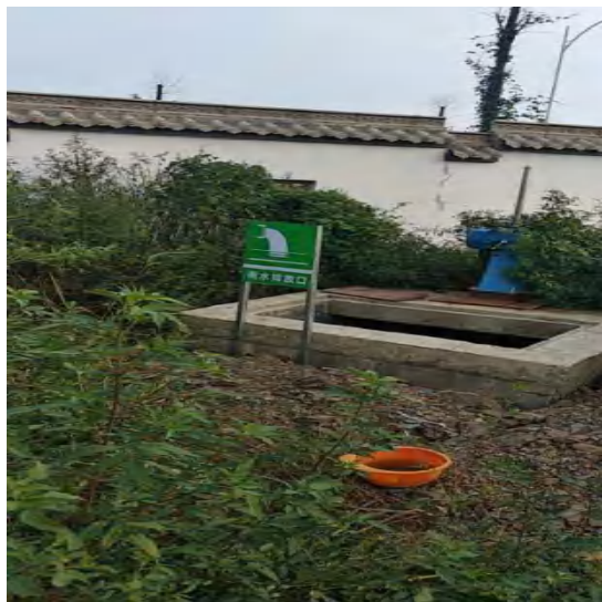
生产区雨排口
